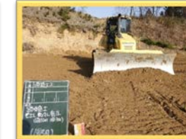
▲ ICT施工(路体盛土敷均し) マシンコントロール 付きブルドーザー
