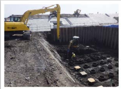
▲ 橋台を作る為に必要な高さまで 地盤を掘り下げる作業
